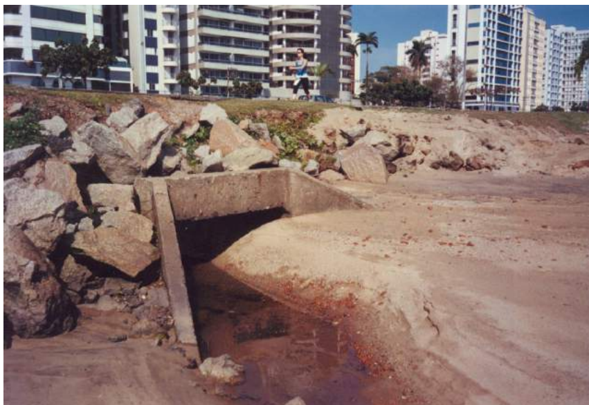
FIGURA 50: Esgoto sendo despejado nas águas da Baía Norte.
